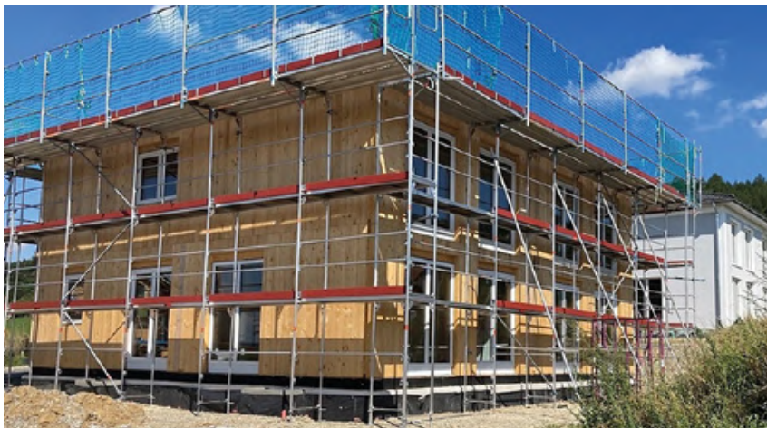
Die rasche Bauzeit und trockene Bauweise sind unter anderem die Vorteile von MHM
